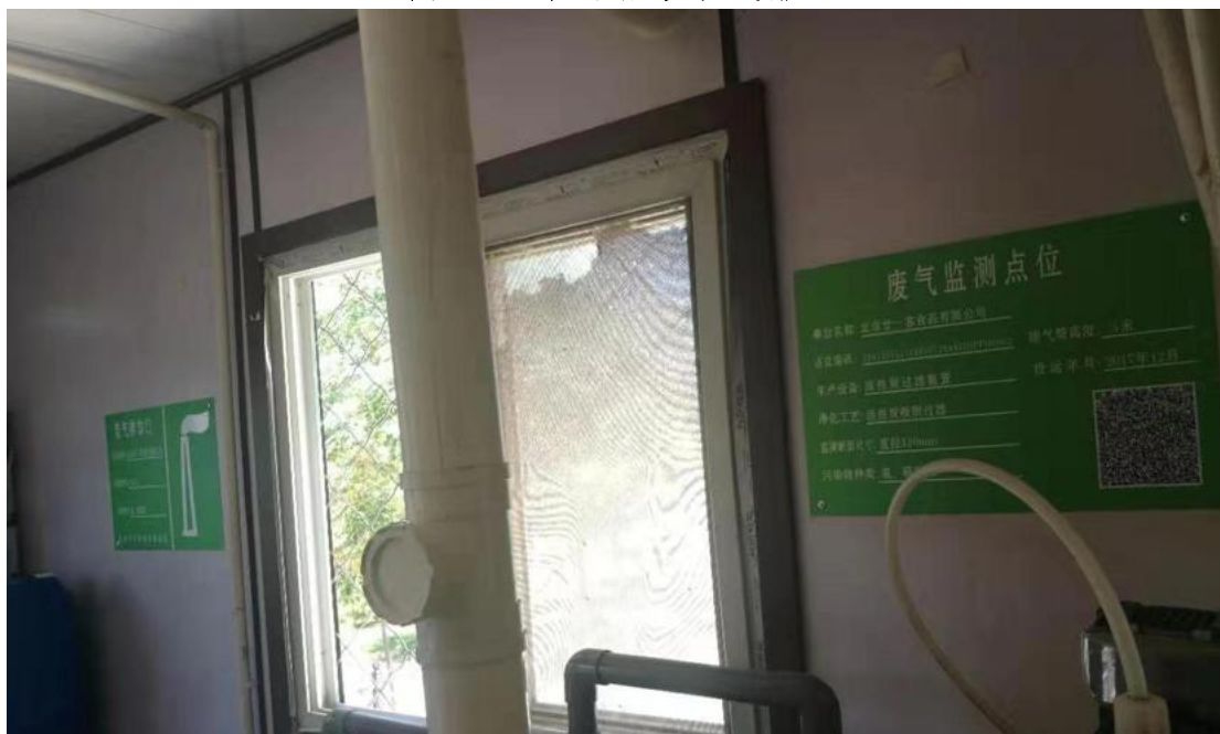
图 4-5 污水站废气排口
