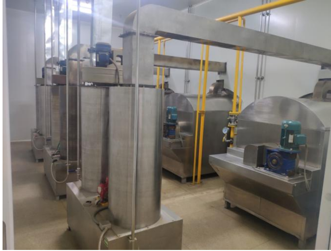
图 4-5 炒药机废气治理设施
