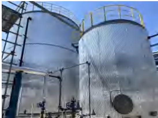
污水处理站一般废水及含盐废水收集罐
