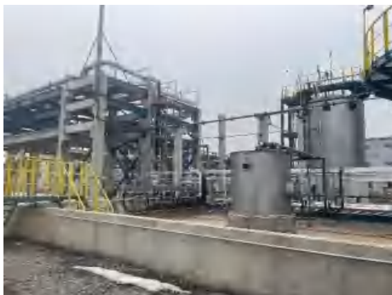
无机罐组区围堰
