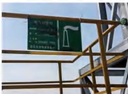
G29 中心化验室废气 4#—DA008 (采样平台、采样口、标识牌)
