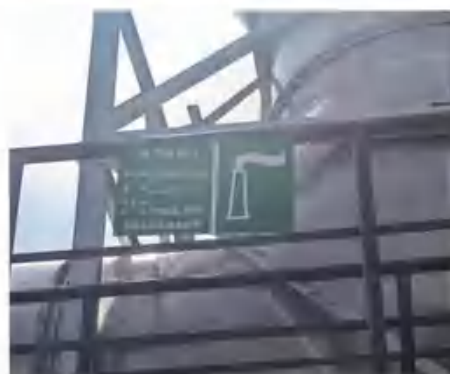
G31 中心化验室废气 6#—DA007 (采样平台、采样口、标识牌)
