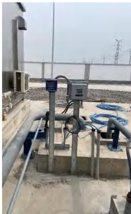
污水总排口流量计及电导率仪
