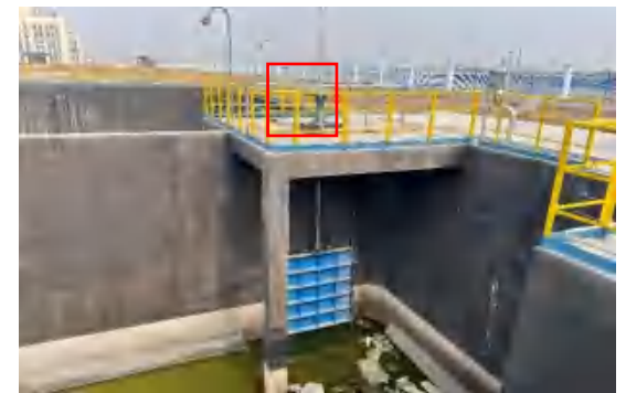
截止阀及闸板 （雨水监控池分区与事故水池分区处）
