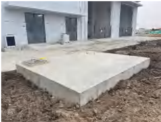
变电所事故油池
