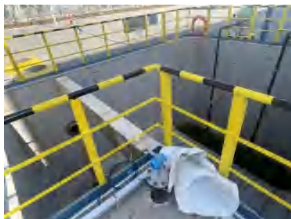
2#雨水收集池（液位仪、提升泵） 罐区
