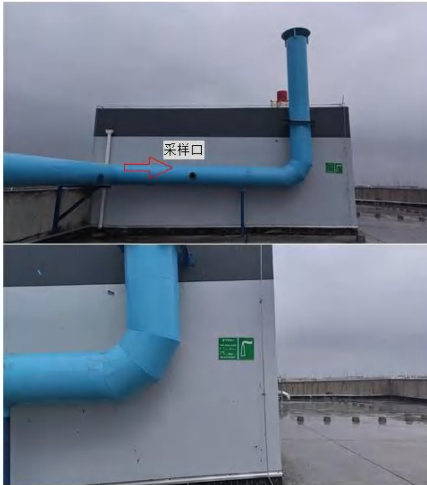
G4 银催化剂含尘废气排放口（采样口、标识）采样口—DA002
