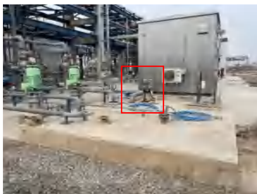
污水总排口 W2 (DW002) 在线监测室
