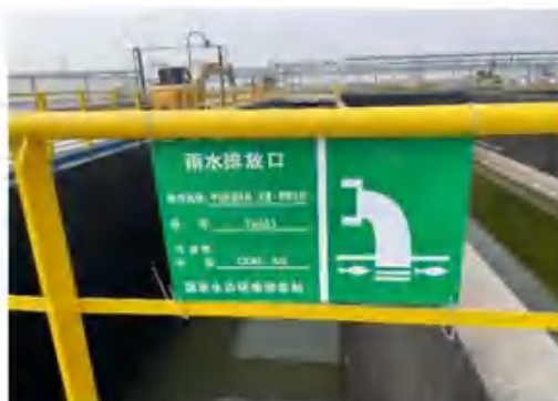
YS001 雨水总排口—DW003
