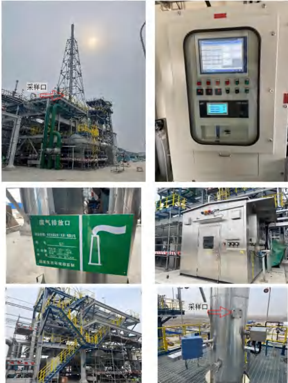
G7-1#焚烧炉烟气排放口（采样平台、标识及在线监测设备）—DA011
