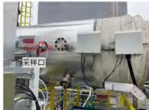
G3 银催化剂焙烧废气排放口（采样平台、标识）—DA001
