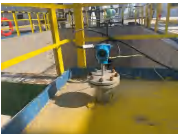
1#雨水收集池（液位仪、提升泵） 聚烯烃装置区
