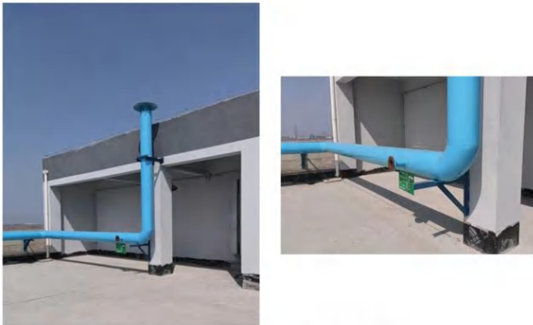
G6 银催化剂包装废气排放口（采样口、标识）—DA014
