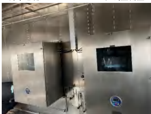
污水总排口 COD、氨氮在线监测
