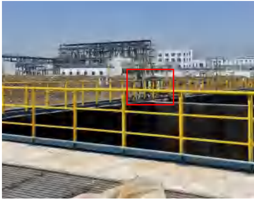
事故水池分区提升泵
