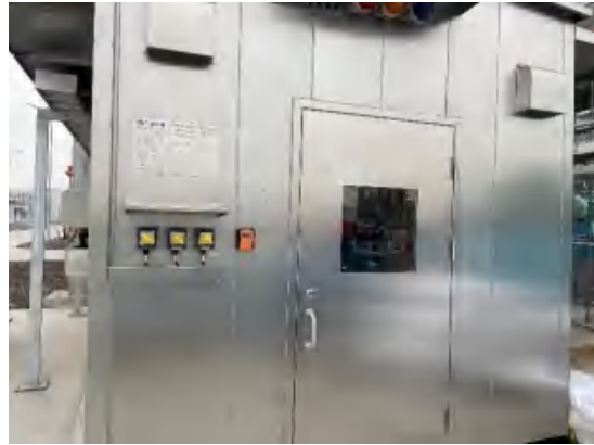
雨水总排口在线监测
